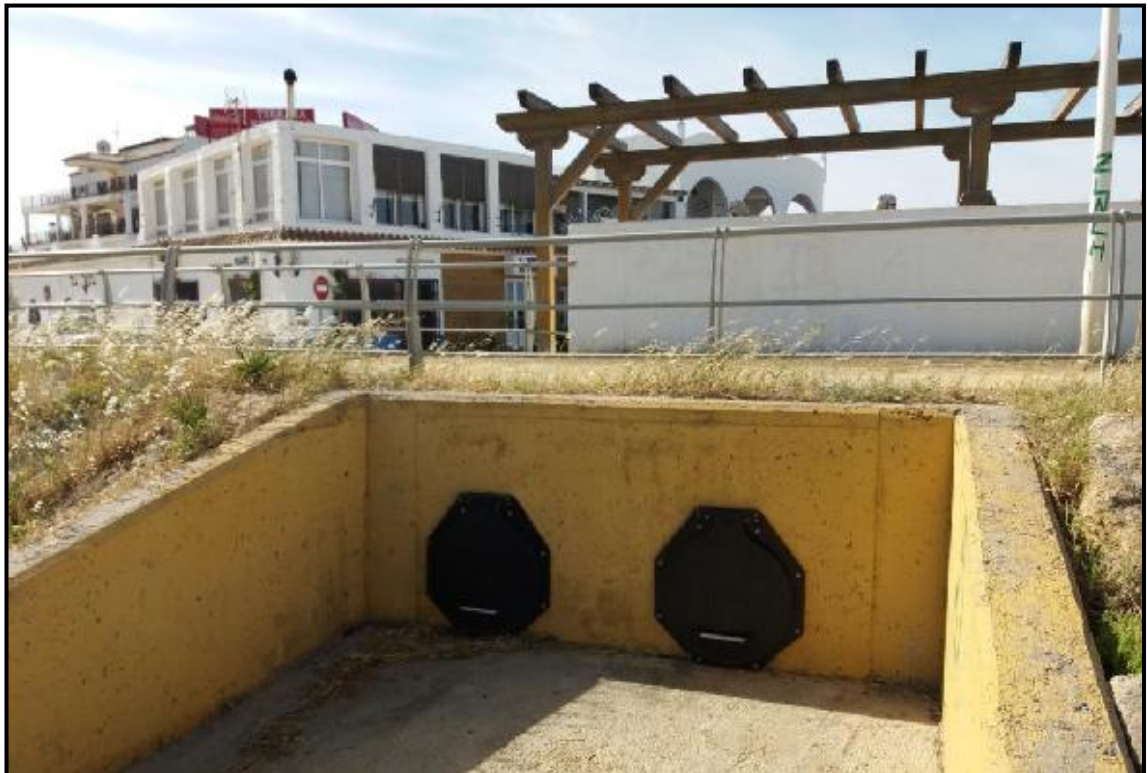
Bombeo con clapetas antirretorno en la mota de defensa
