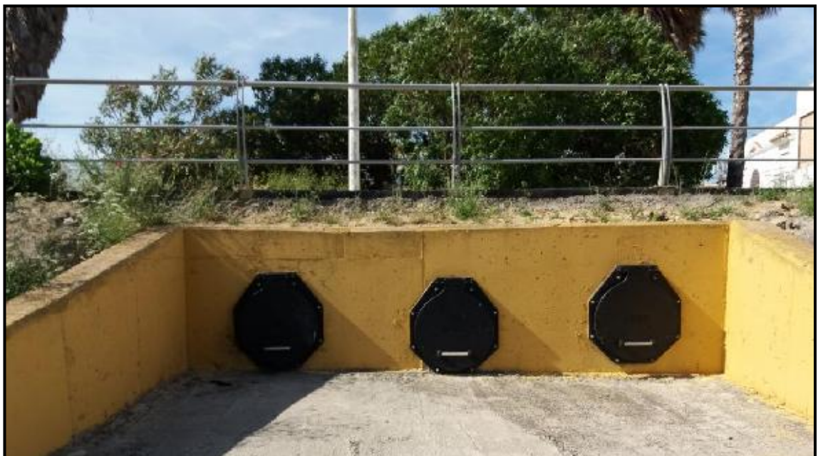
Bombeo con clapetas antirretorno en la mota de defensa
